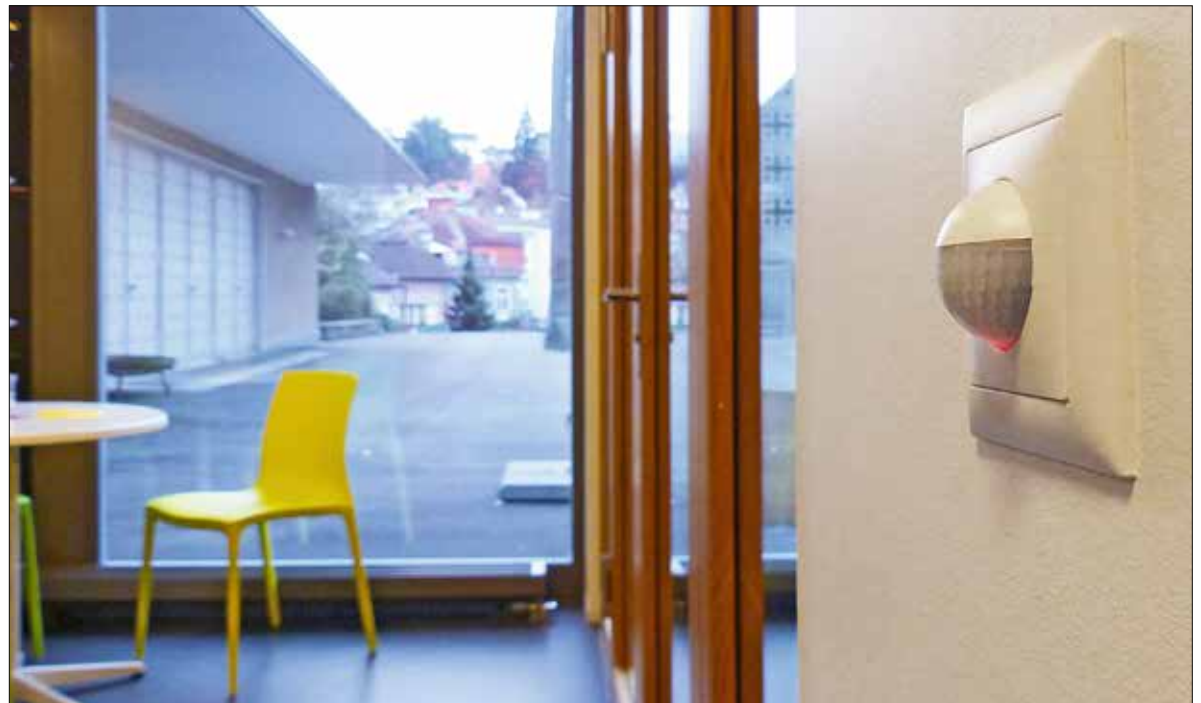
Ein Bewegungsmelder. Er sorgt dafür, dass im MaiHof die Lichter automatisch angehen. Für andere ebenso wichtige und noch viel wichtigere Dinge sind Menschen zuständig. Foto: Urban Schwegler
