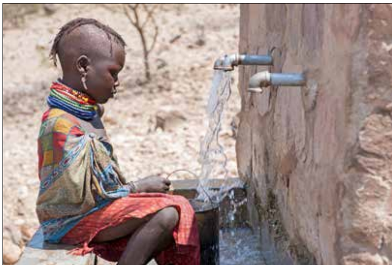
Dank der Hilfe der Sternsingerinnen und Sternsinger gibt es diesen Brunnen, der Menschen, Tiere und Gemüsegärten mit Wasser versorgt.
