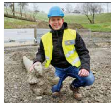
Claudio Ganassi auf der Baustelle bei der erfolgreichen Durchbohrung des Sonnenbergs. Foto: zvg
