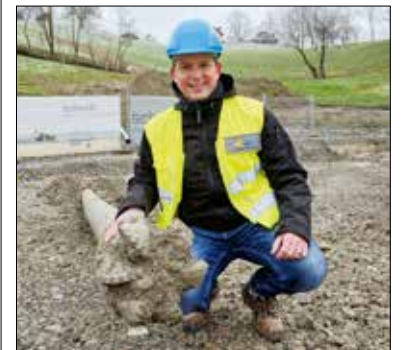
Claudio Ganassi auf der Baustelle bei der erfolgreichen Durchbohrung des Sonnenbergs. Foto: zvg
