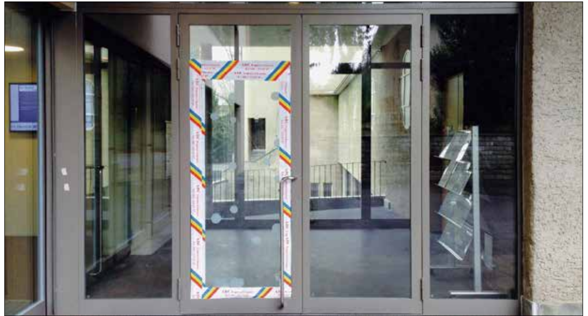
Die Türe zum Zentrum «MaiHof» wurde in der Nacht auf Neujahr durch einen Vandalenakt zerstört. Foto: Pascal Müller
