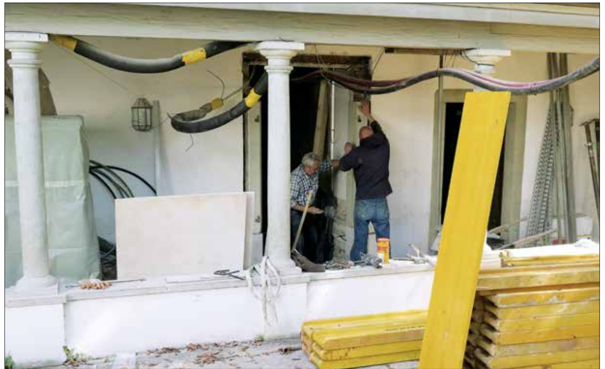
Hier wird gearbeitet: Umbauarbeiten am Pfarrhaus von St. Maria zu Franziskanern. Foto: Urban Schwegler
