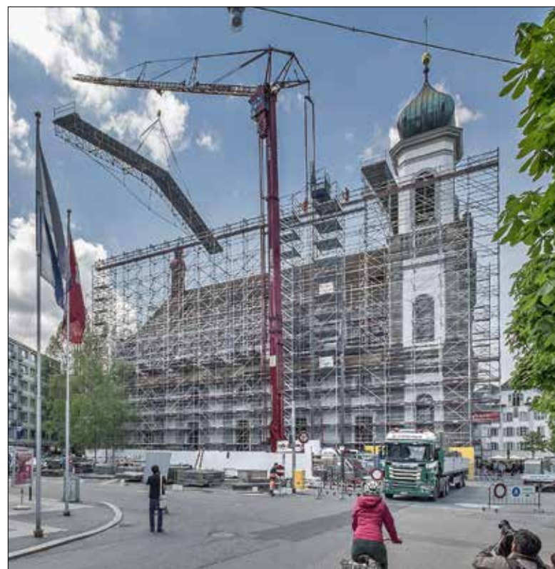
Das Dach der Luzerner Jesuitenkirche ist in schlechtem Zustand – sowohl innen wie auch aussen. Deshalb wird es in den kommenden zwei Jahren saniert. Darum präsentiert sich die Kirche im ungewohnten Gerüstkleid. Foto: Roberto Conciatori
